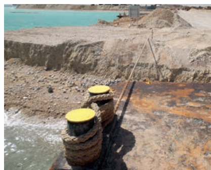
Snapback-Zone: Beim unverhofften Reißen eines Seils wird der Schlag vom Sanddeich aufgefangen.
