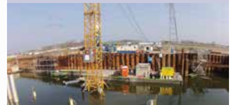
| Imagen del acueducto inundado en Muiden
